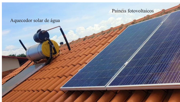
Figura 5.3 - Sistemas solares instalados com inclinação de 33% e azimute de 320°.
